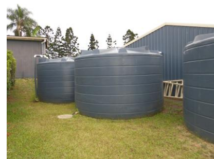
雨水を貯めるタンク
