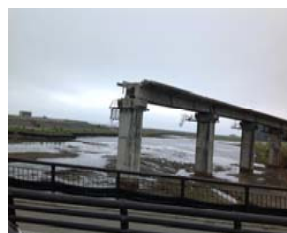
(津波で壊された小泉地区の橋)
